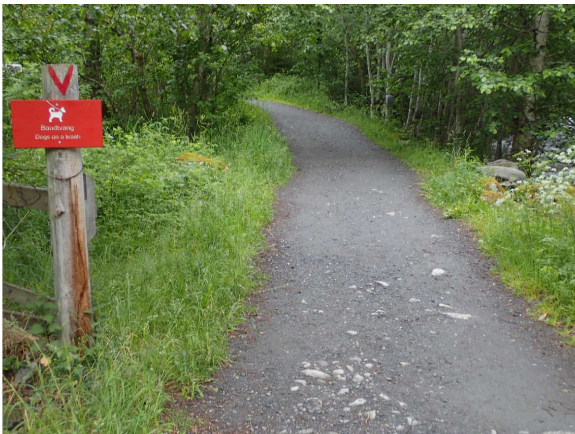
Figur 13. Etter kryssing av Vesteråselva kommer man inn i skogen. Da er stien først ganske flat, en oppgruset turvei i ca. 2-2,5 m bredde. Dette kan være tilstrekkelig tiltak mot erosjon, men bør overvåkes.
